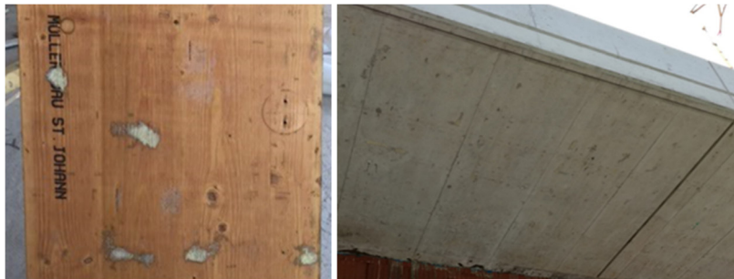
Beschädigungen auf Platte und Betonbild, verursacht durch falsche Anwendung des Rüttlers.
